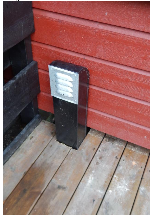
Luftekanal-forlengere leder vekk ut-luften fra leilighetene i sokkeletasjen i rekkehusene - utenfor panelkledningen.
